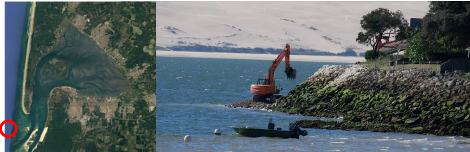
Figure 8 : Photos du Perré de M. Ullman – Lège-Cap Ferret.
