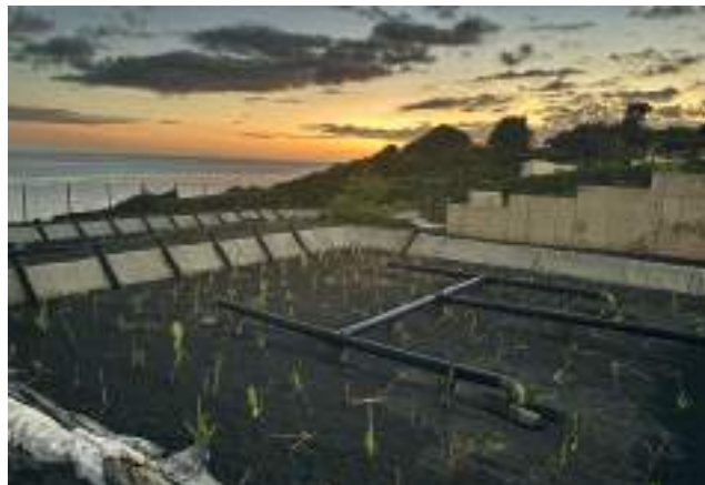
Construction d'un système d'assainissement sur la commune de Vieux-Fort en Guadeloupe Crédit : OFB
