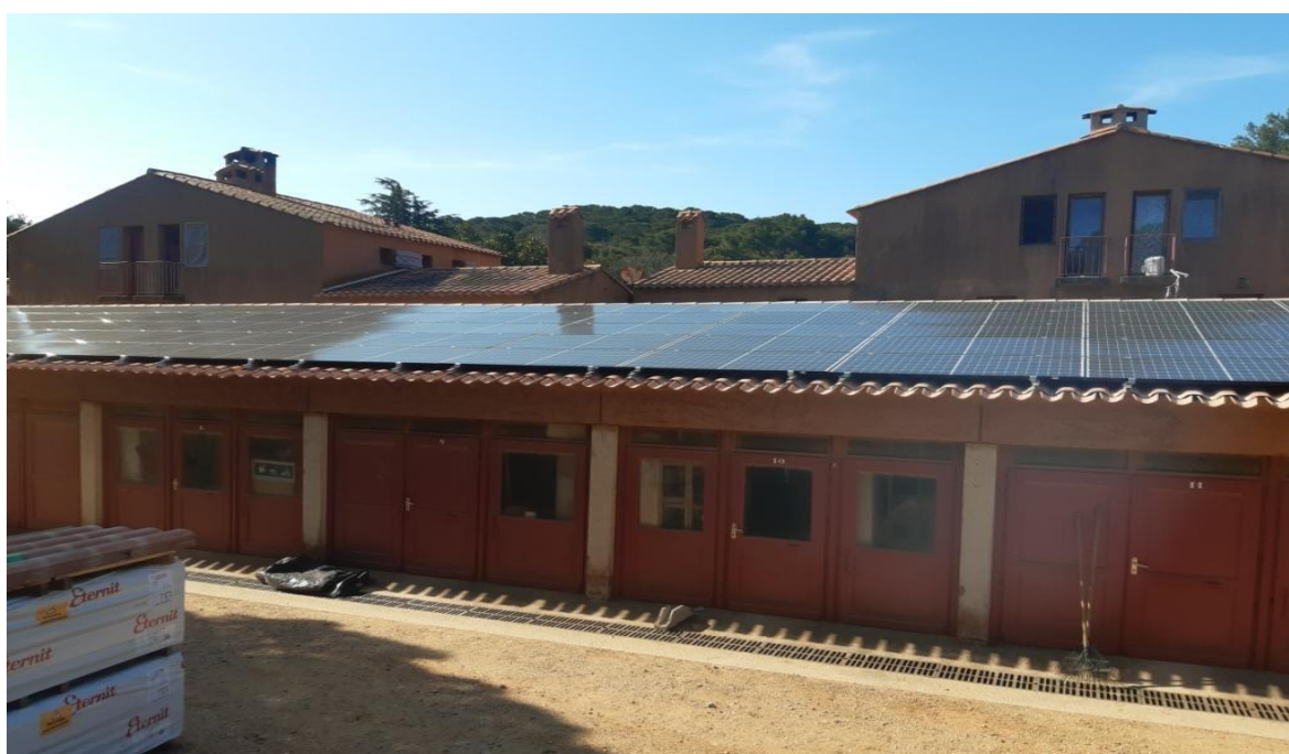
Figure 3. Panneaux photovoltaïques - Parc national de Port Cros (hameau de Porquerolles). © Parc national de Port Cros
