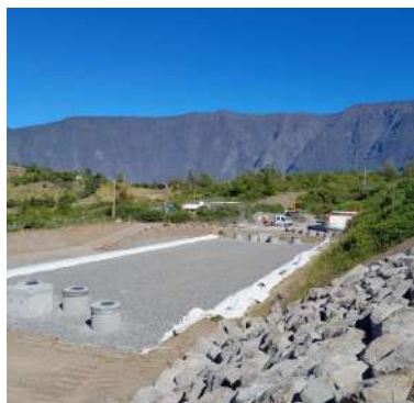
Zone d'infiltration STEP à Cilaos © Grégoire SAVOUREY / OFB
