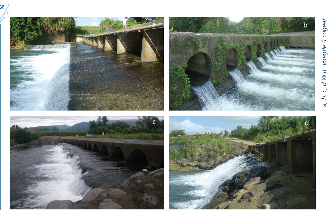
Exemples de chutes en aval d’ouvrages routiers. (a) Pont de Ravine Chaude sur la Grande Rivière à Goyaves (Guadeloupe), (b) Rivière Blanche (Martinique), (c) Radier Beauvallon sur la rivière des Roches (La Réunion), (d) Pont Baimbridge sur la Grande Rivière à Goyaves (Guadeloupe).
