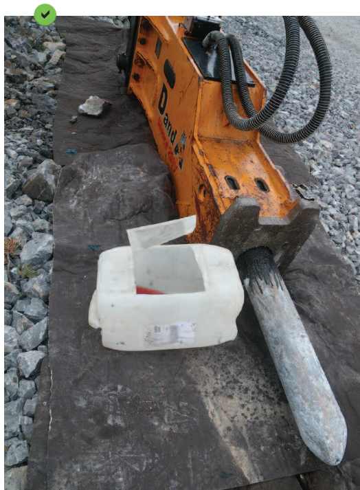
Équipement posé sur géotextile absorbant.
