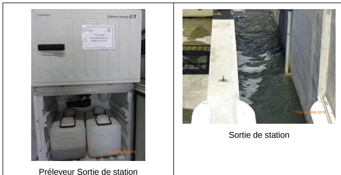
Illustration 11 - Installations en sortie de la STEU du Grand-Prado
