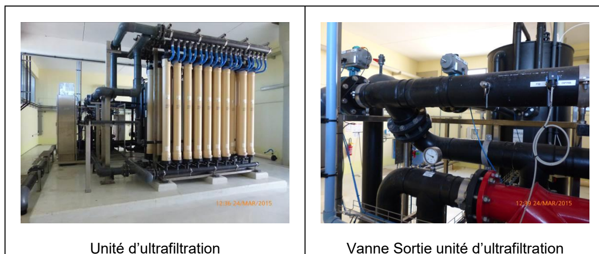
Illustration 12 - L'unité d'ultrafiltration de la station du Grand-Prado.
